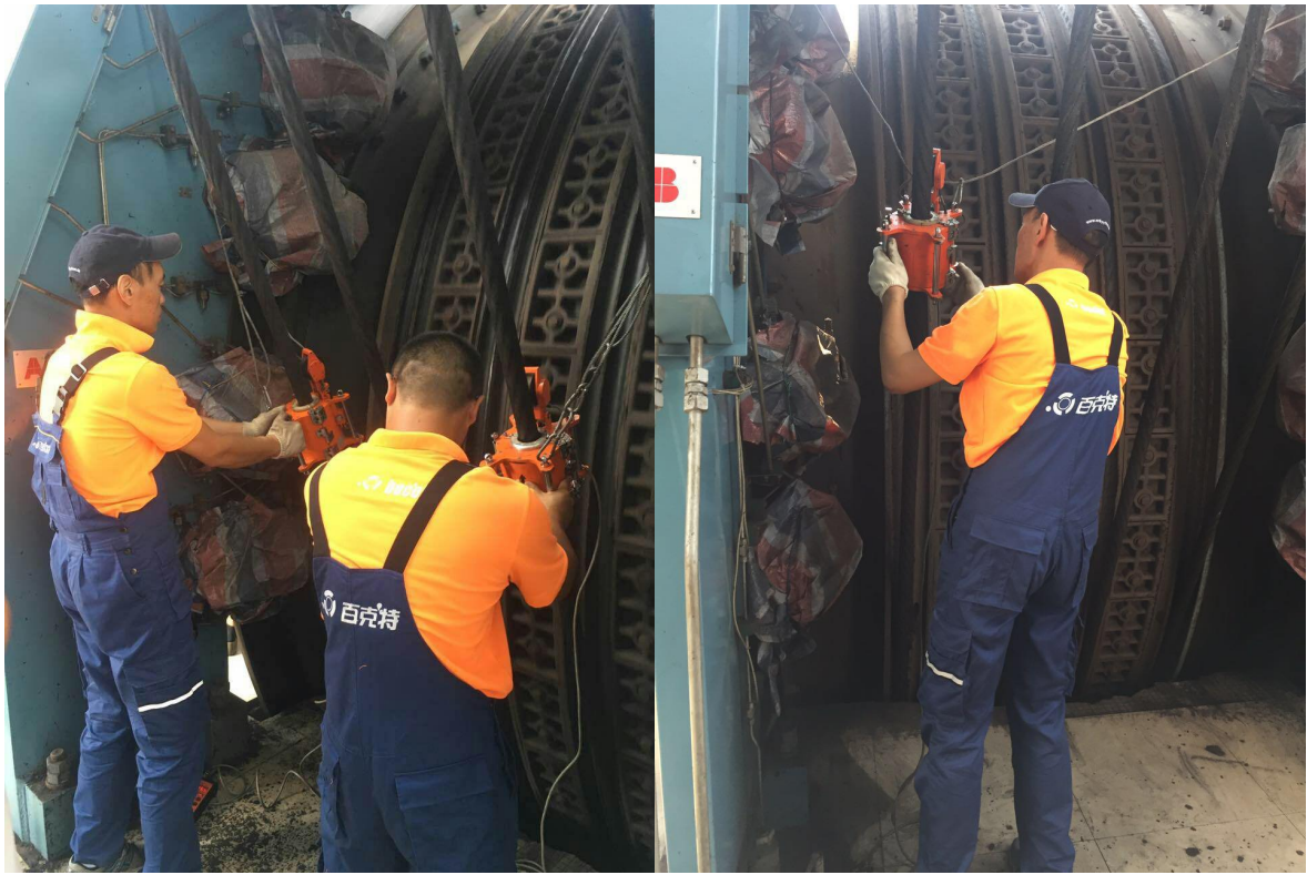
落地式提升机检测现场
